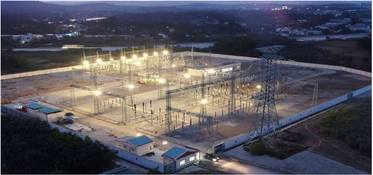
Trạm biến áp 220kV An Khê và Đầu Núi
