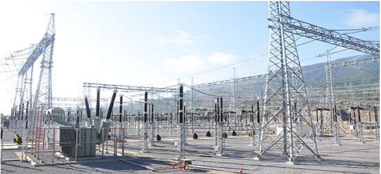
Trạm biến áp 500kV Sơn La
